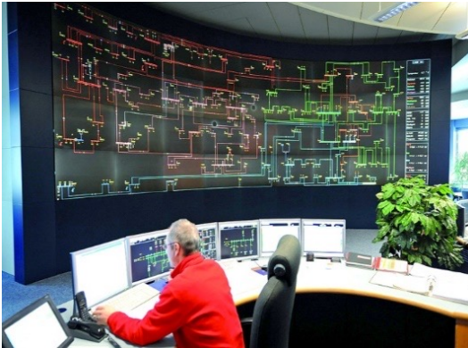
Foto: Archiv NetzeBW
